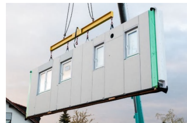
規格化された部材一式を工場生産し作った組み立てユニットを、現地で積み立てるように設置するプレハブ住宅（イメージ）
