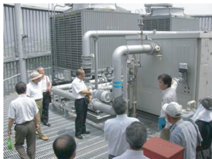
屋上にある空調設備の一部
