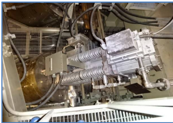
4号機原子炉格納容器の主蒸気隔離
