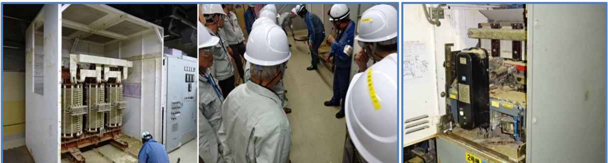
海水熱交換器建屋電源盤室の変圧器津波後・仮設ケーブル・電源用遮断器
